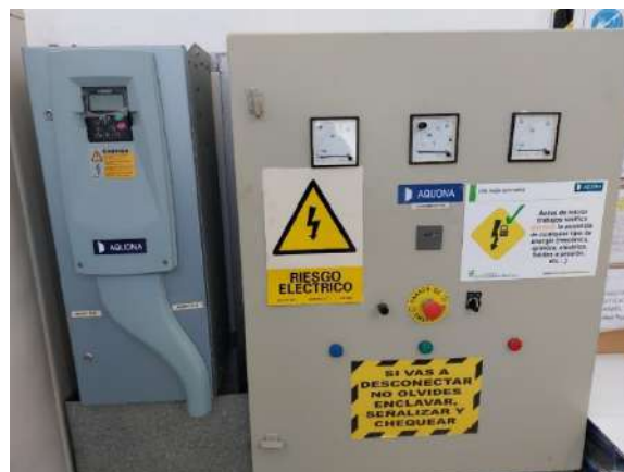
Figura 13. Cuadro eléctrico planta descalcificadora
