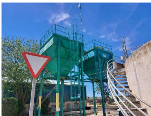
Figura 59. Tolvas de almacenamiento del fango deshidratado.
