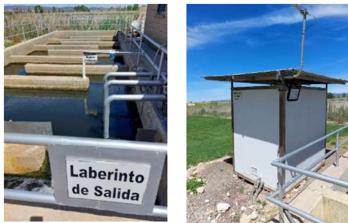
Figura 55. Laberinto de salida antes del punto de vertido(izq.) y Estación de control de la Confederación Hidrográfica del Guadiana (drcha.)
