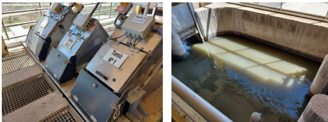
Figura 45. Desbaste de finos y cámara de entrada al desarenador-desengrasador
