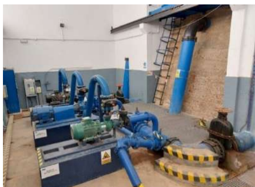
Figura 22. Grupo de bombeo de la ETAP
