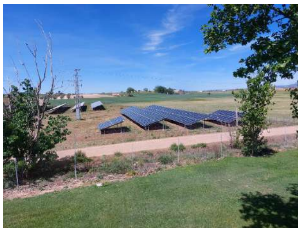
Figura 61. Planta fotovoltaica de la EDAR
