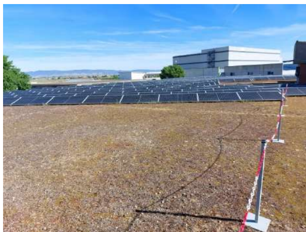
Figura 21. Planta fotovoltaica en la ETAP
