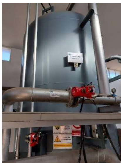
Figura 14. Tanque de descalcificación
