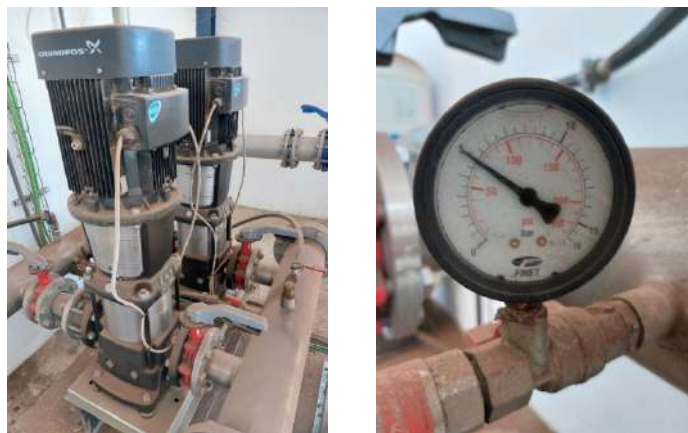
Figura 64. Grupo de bombeo sondeo P.I Campillo (izquierda) y Manómetro (derecha)
