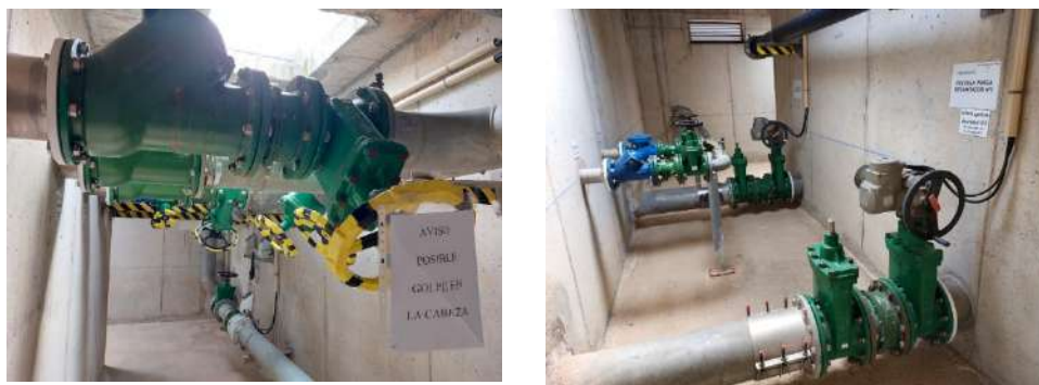
Figura 53. Tuberías de fangos en exceso (izquierda) y válvulas de los decantadores
