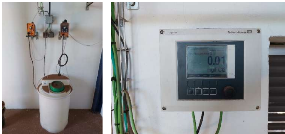
Figura 65. Dosificación de cloro del sondeo de P.I Campillo
