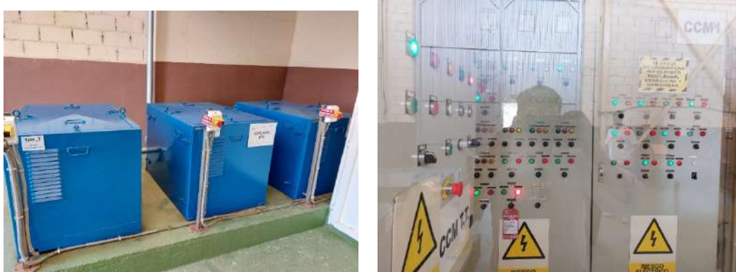
Figura 47. Equipos eléctricos y cuadro de control
