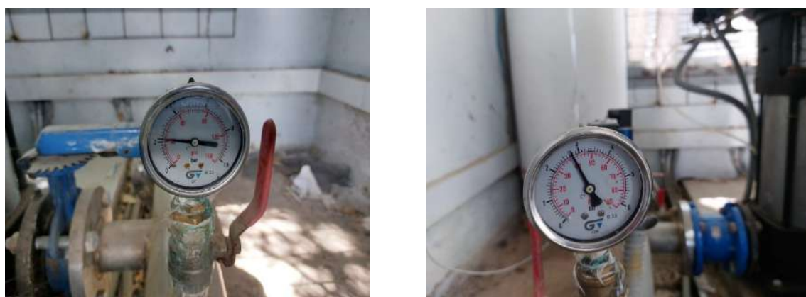
Figura 27. Manómetro entrada grupo de bombeo(izquierda) y Manómetro salida grupo de bombeo (derecha).
