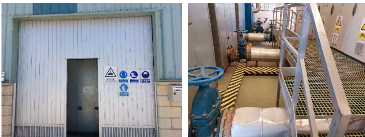
Figura 50. Edificio soplantes aireación reactores biológicos exterior e interior
