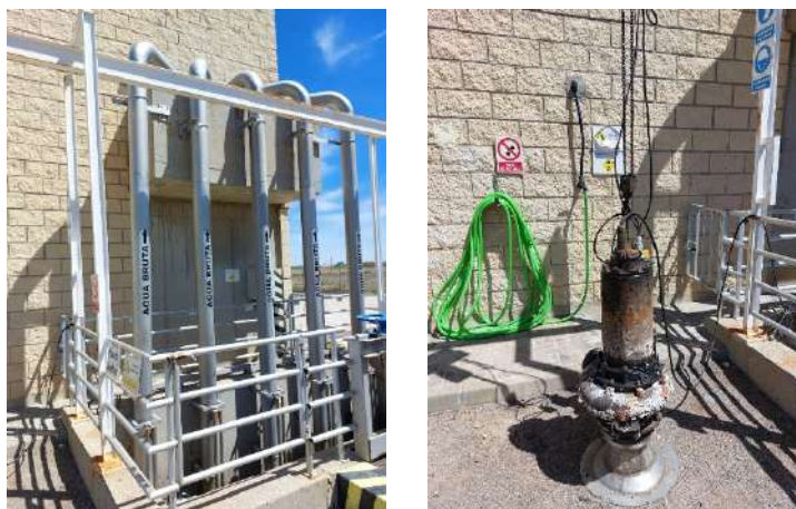
Figura 44. Bombeo de impulsión de agua bruta (izquierda) y bomba sumergible del grupo de bombeo (derecha).
