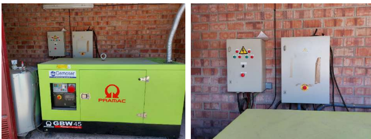
Figura 31. Grupo electrogenerador (izquierda) y equipo de control de la EBAR (derecha).
