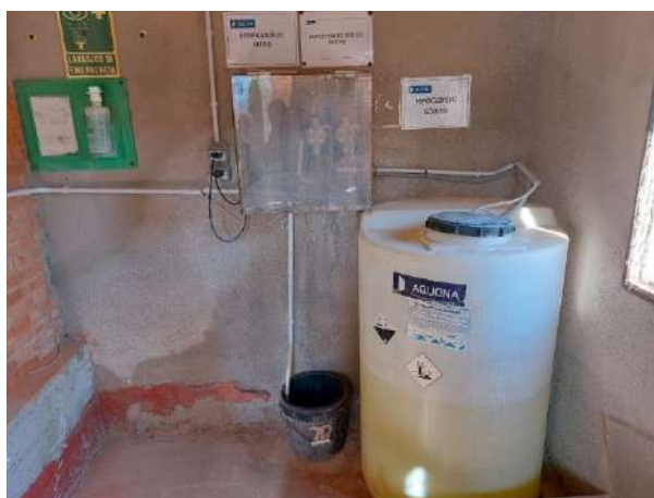
Figura 16. Cloración en depósitos de la ETAP
