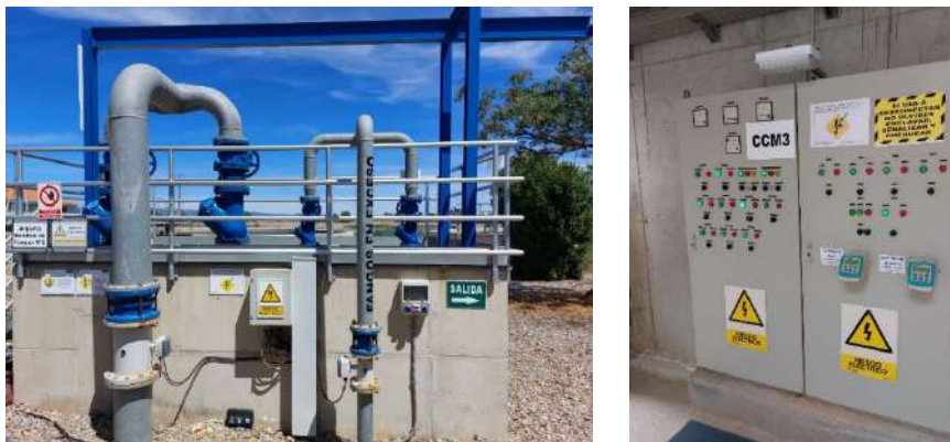
Figura 52. Bombeo de fangos en exceso (izquierda) y cuadro de control (derecho).
