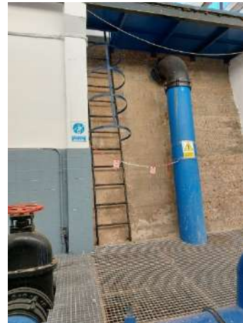
Figura 18. Tubería de entrada al Depósito nº1
