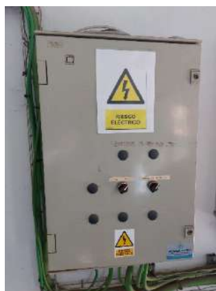
Figura 66. Cuadro eléctrico y de control del sondeo P.I Campillo
