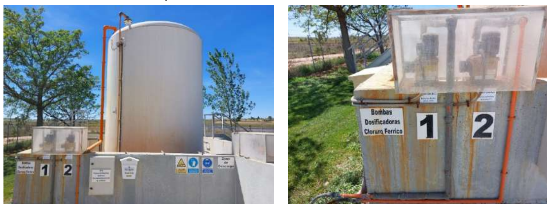
Figura 48. Depósito (izquierda) y bombas dosificadoras de cloruro férrico (derecha).
