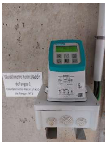
Figura 54. Caudalímetro recirculación de fangos.
