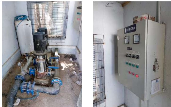
Figura 26. Grupo de bombeo (izquierda) y Cuadro eléctrico y de control (derecha).
