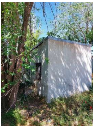
Figura 25. Vista exterior caseta grupo de bombeo zona alta de Daimiel
